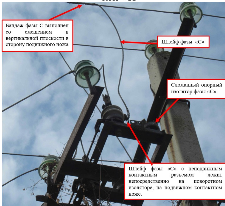
Опора № 3/11 воздушной линии электропередачи 10 кВ Ф-227
