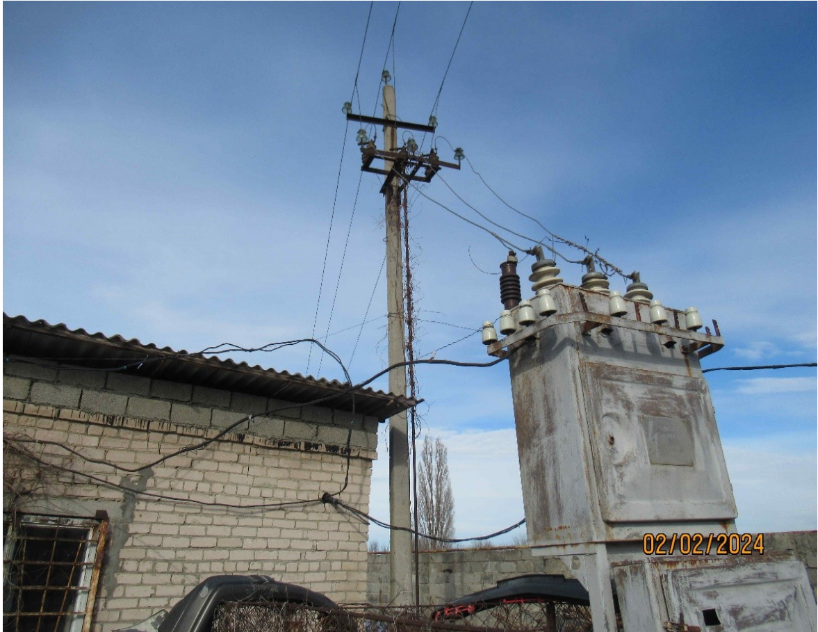
Опора №3/11 ВЛ 10 кВ Ф-227
